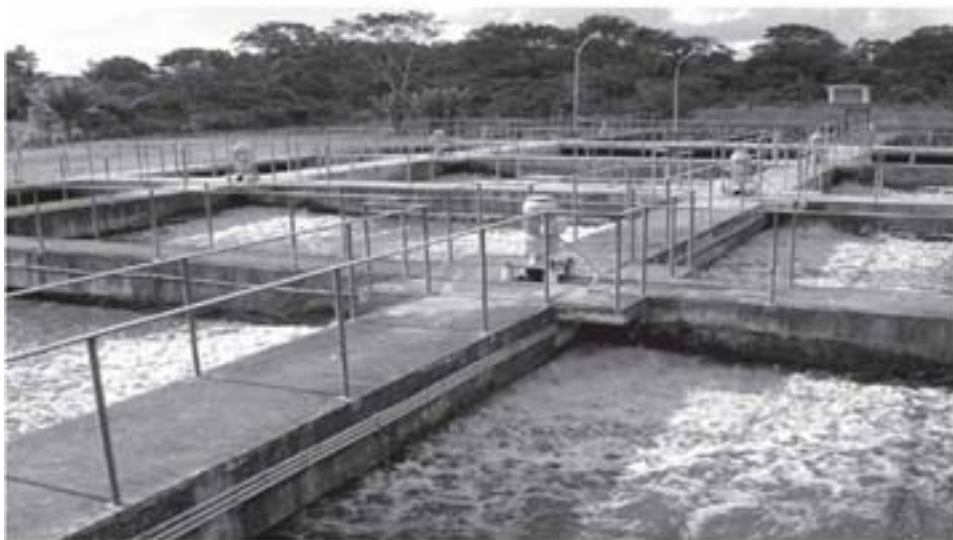
Tratamento de Esgoto.
